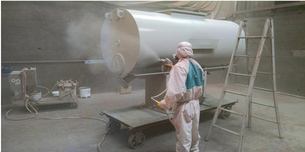
Figura 11 – Pintura de um tanque de compensação de óleo de um transformador elétrico em 06/04/2015, em Jundiaí -SP.
